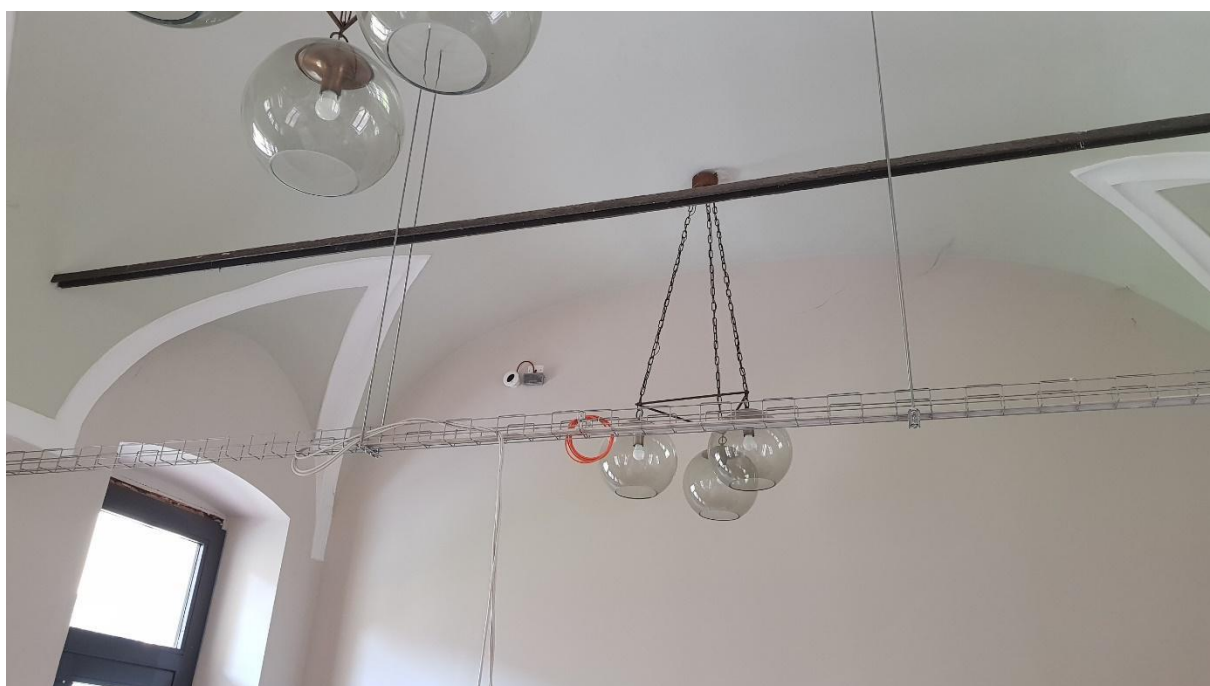
PTZ da fissare alle barre metalliche parallele al soffitto
