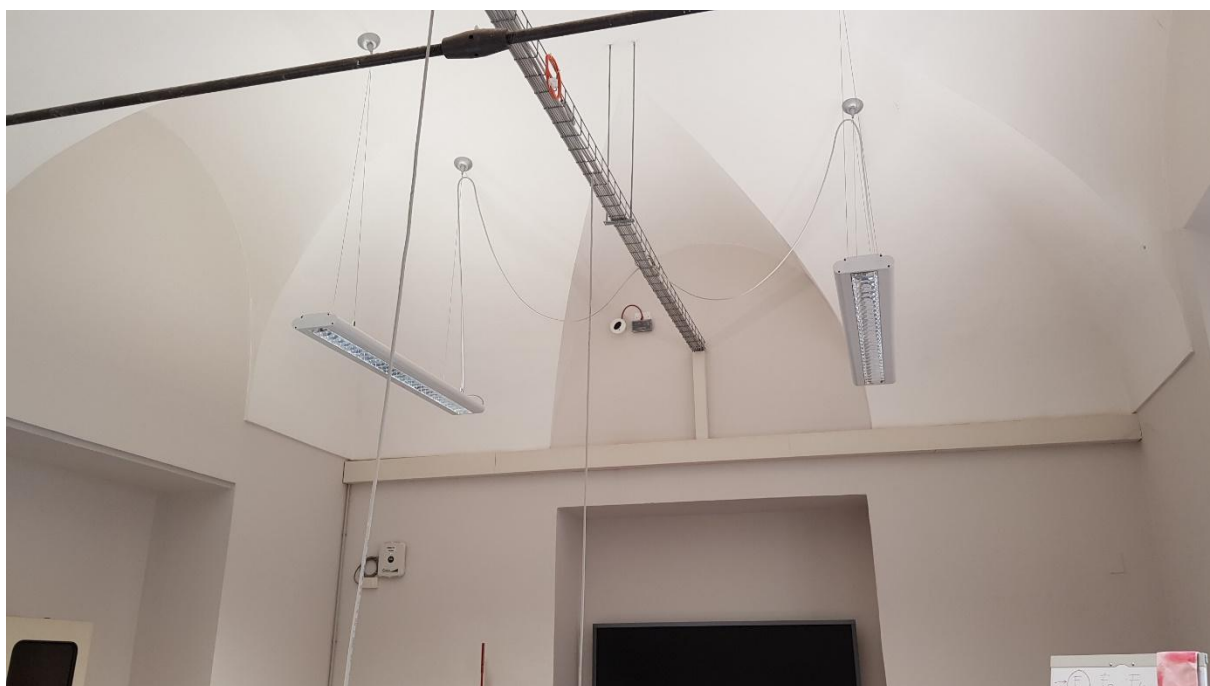
PTZ da fissare alla grata metallica parallela al soffitto
